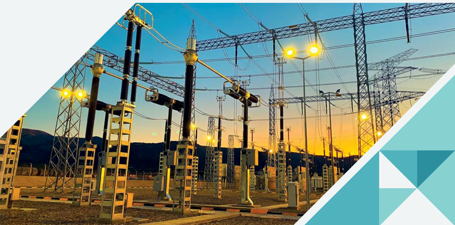
Subestación Santivañez 500 kV, Línea de Transmisión Carrasco - Santivañez en 500 kV - ENDE TRANSMISIÓN
