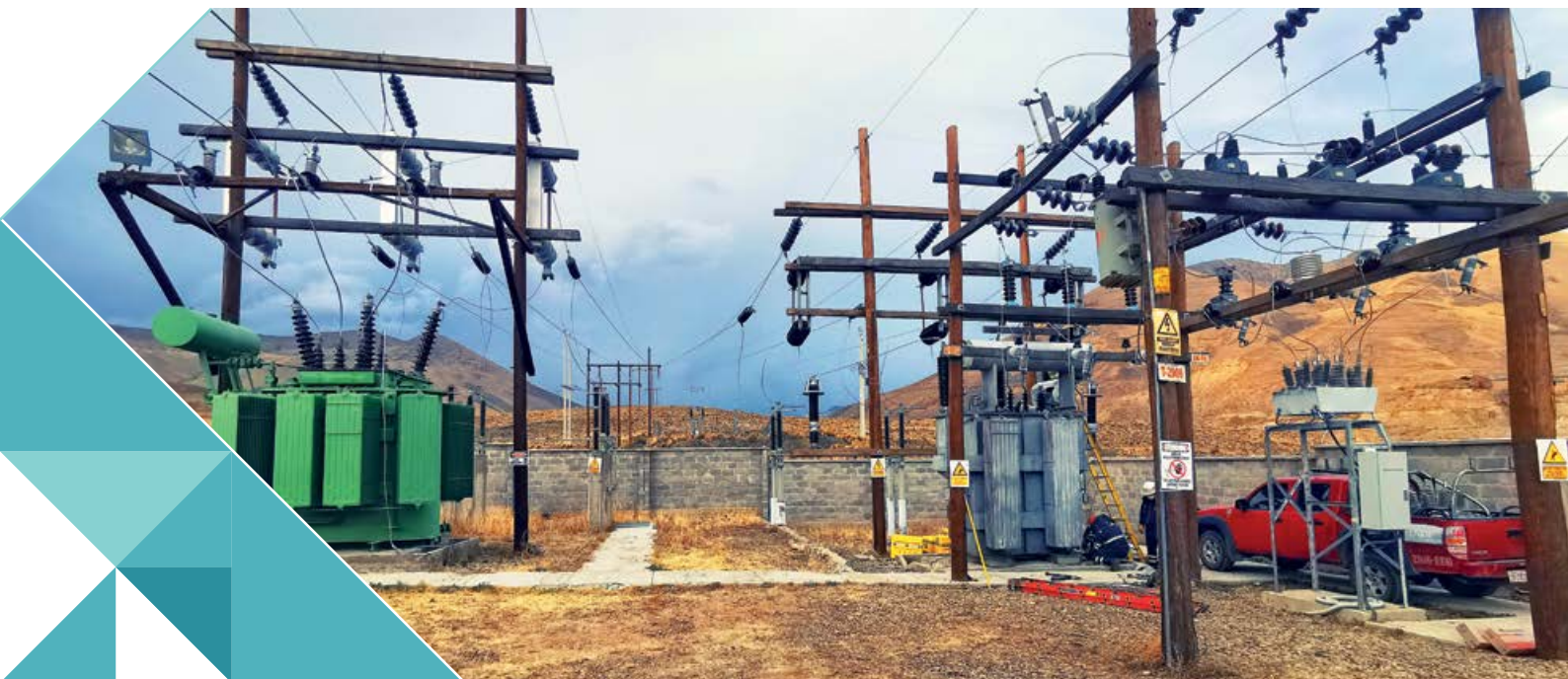
Transformador 69/24,9 kV en Subestación Avicaya - ENDE DEORURO
