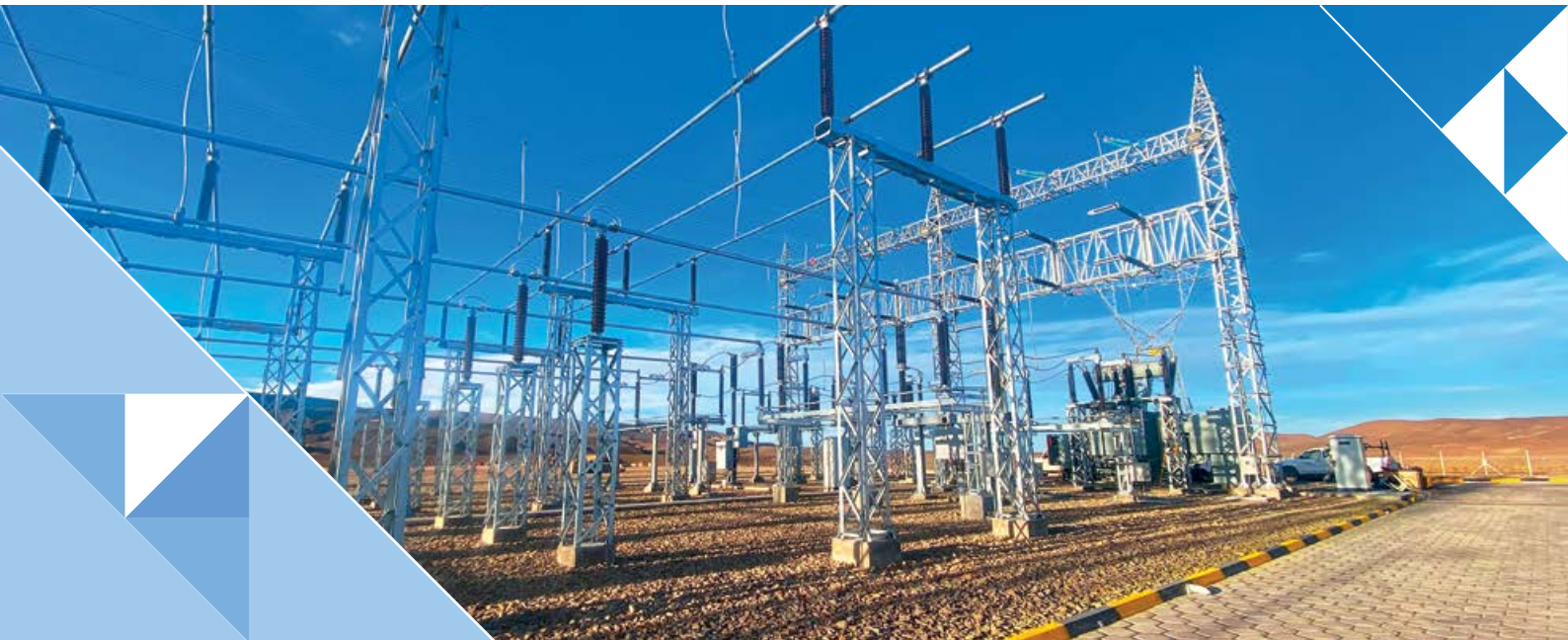
Subestación Lito 115 kV - SEPSA
