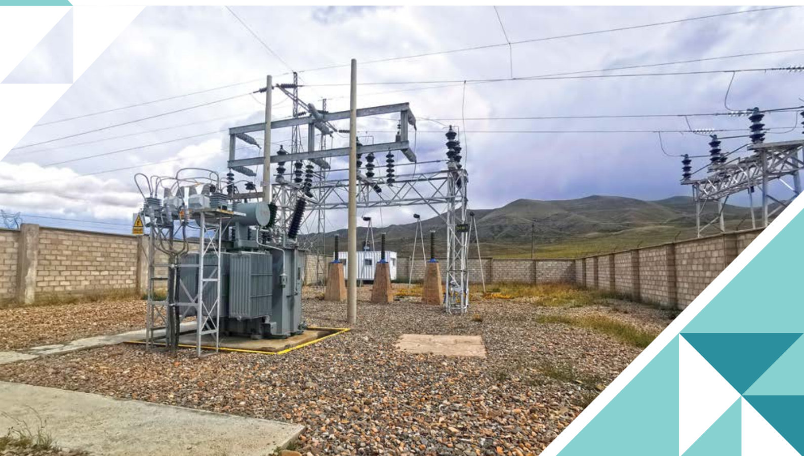
Transformador en Subestacion Machacamarca - ENDE DEORURO
