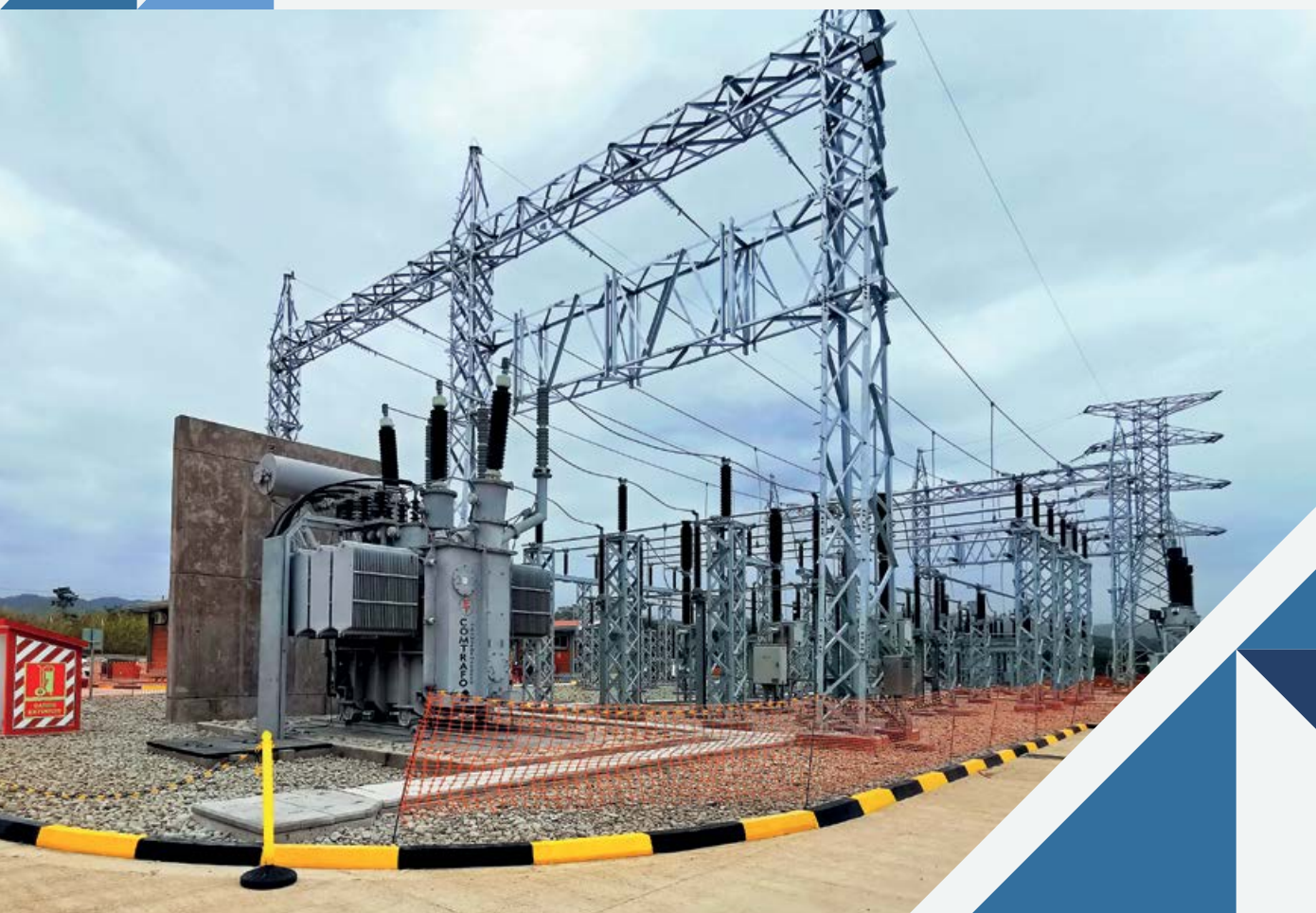
Conexión Sistema Bermejo al SIN - SETAR
