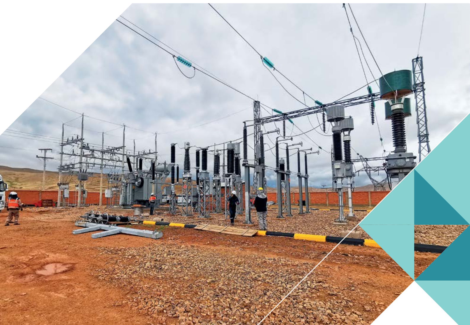
Transformador de potencia 12,5 MVA en Subestación Ocuri - SEPSA
