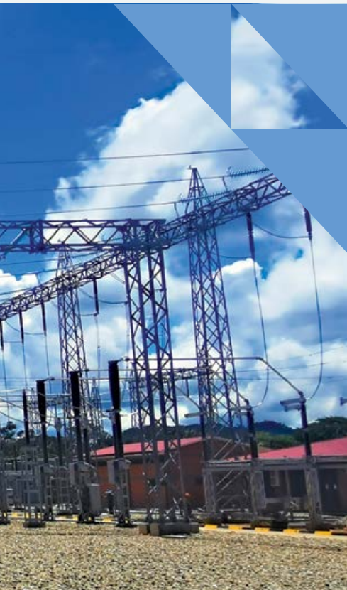
Subestación Guarayos Interconexión 230 kV Santa Cruz - Beni - ENDE TRANSMISIÓN
