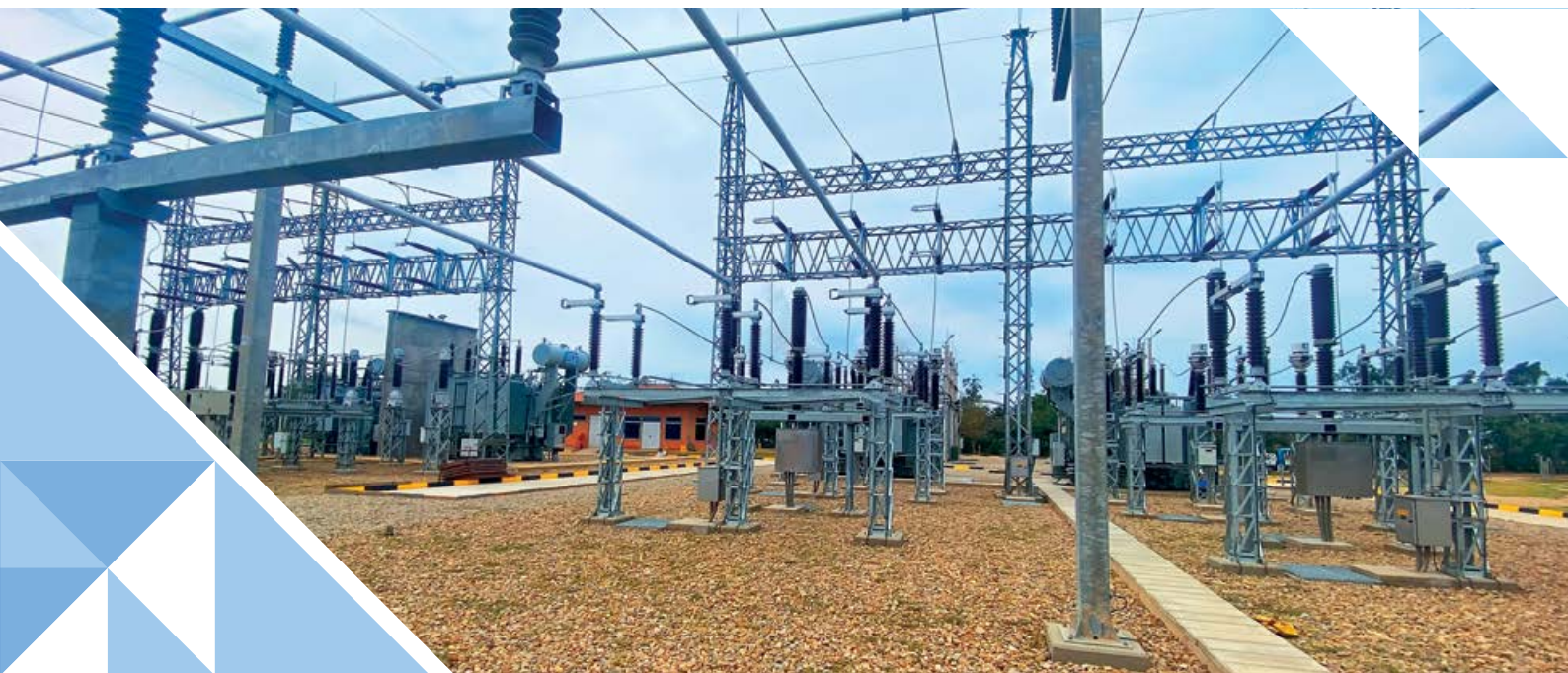
Subestación Aguai 115 kV - CRE
