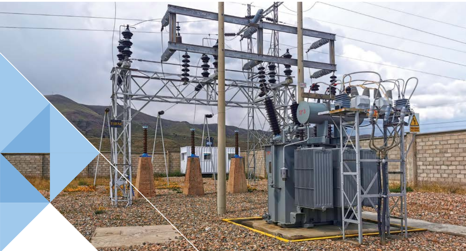
Subestacion Machacamarcá 69 kV - ENDE DEORURO
