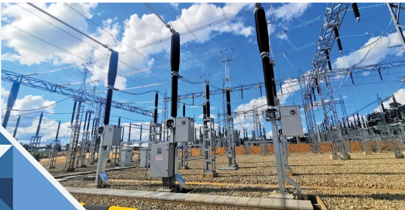
Subestación Guarayos - Interconexión 230 kV Santa Cruz - Beni - ENDE TRANSMISIÓN
