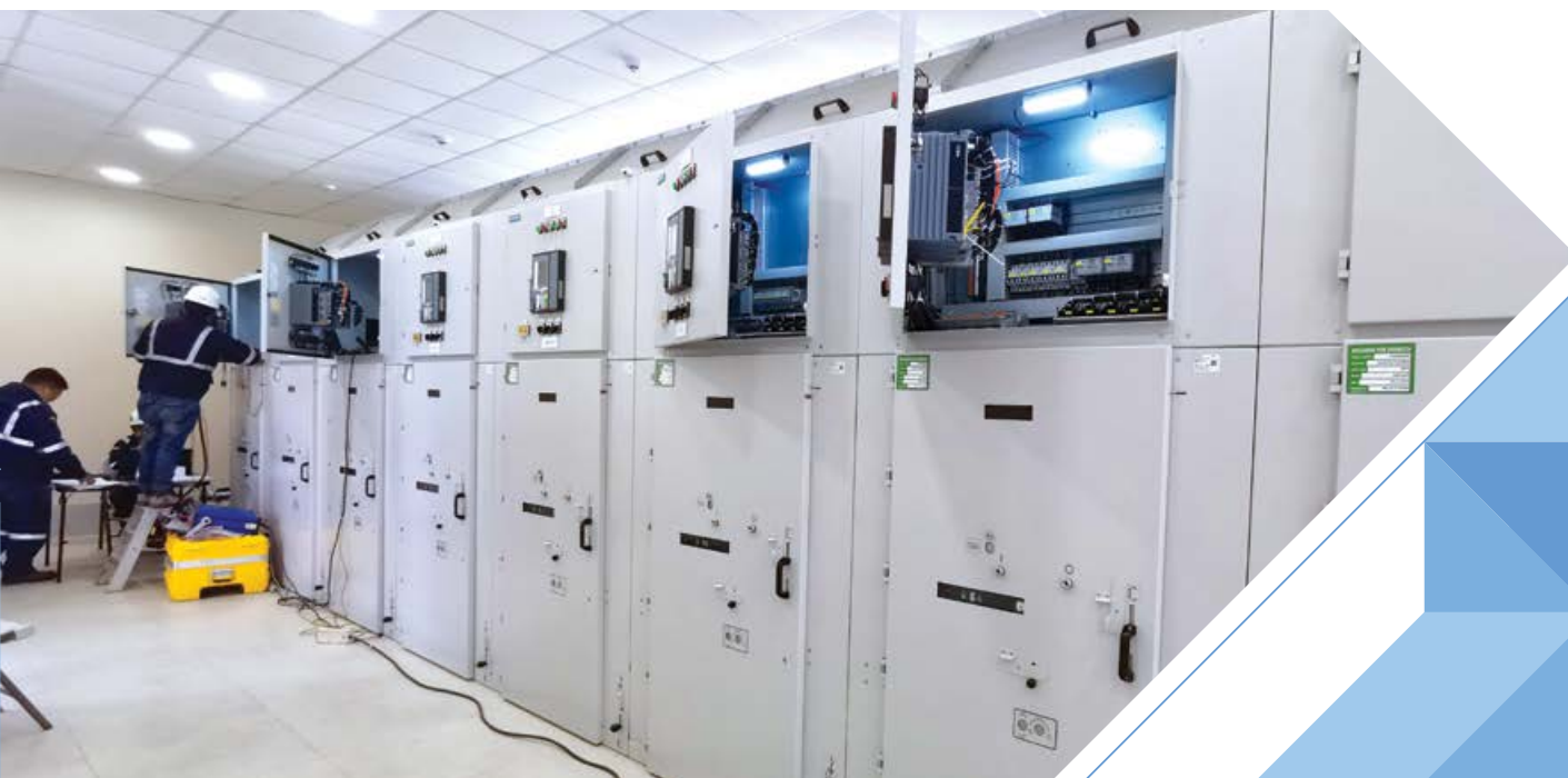
Subestación Huarina 115/24,9 kV - DELAPAZ
