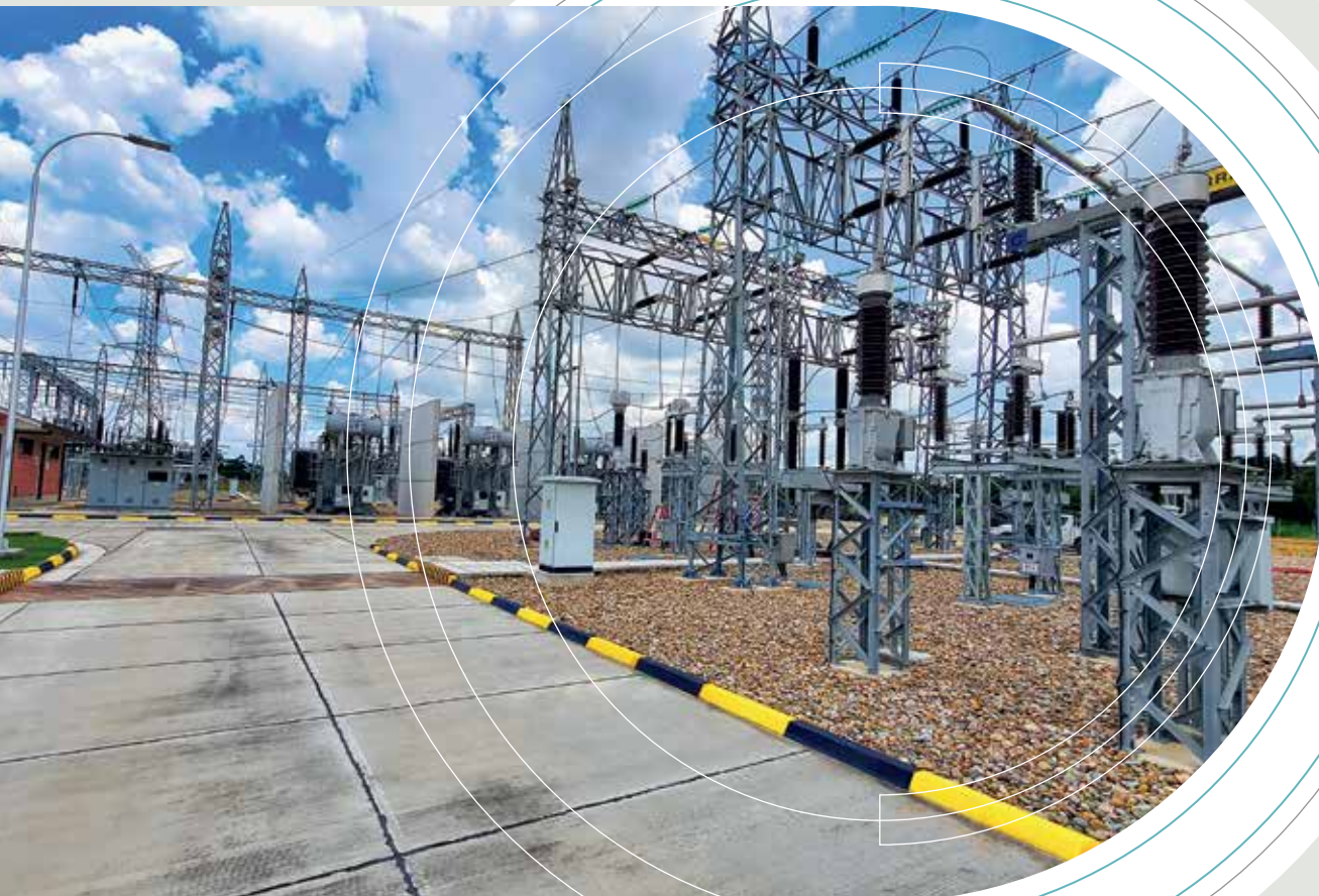
Subestación Yapacaní 115 kV - CRE
