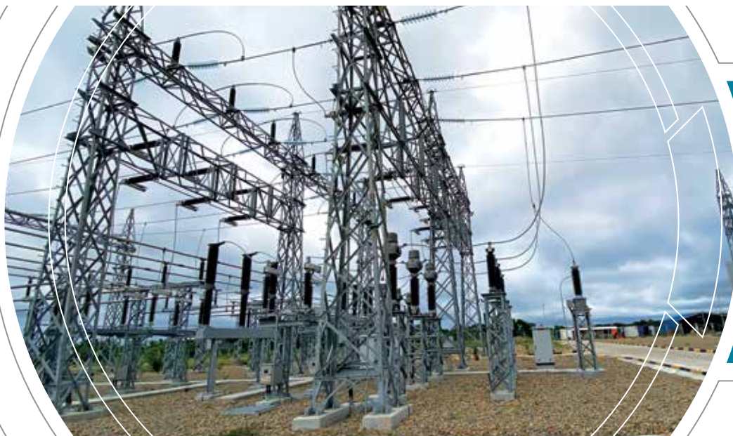
Subestación Bélgica 230/115 kV - ENDE TRANSMISIÓN
