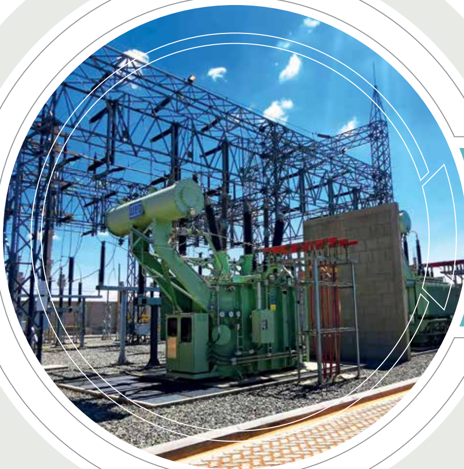
Subestación Viacha Pueblo 115 kV - DELAPAZ
