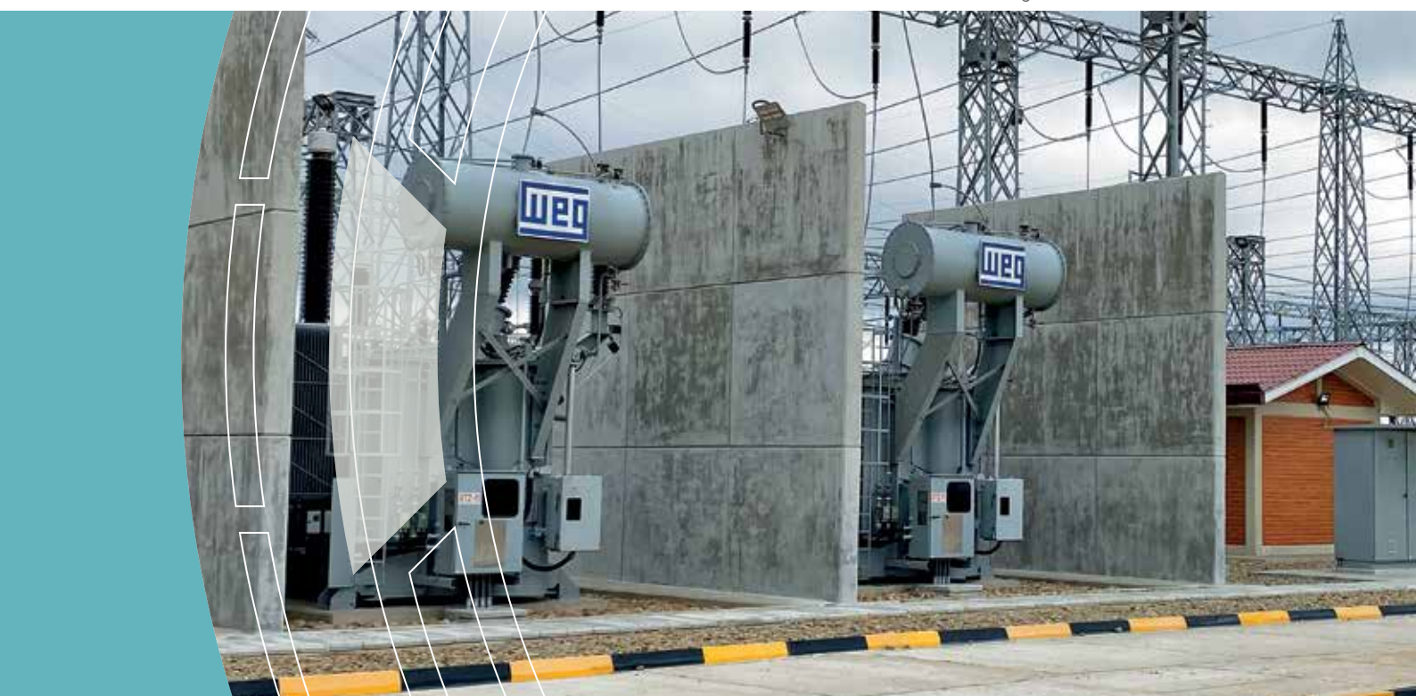
Transformador 230/115 kV Subestación Bélgica - ENDE TRANSMISIÓN
