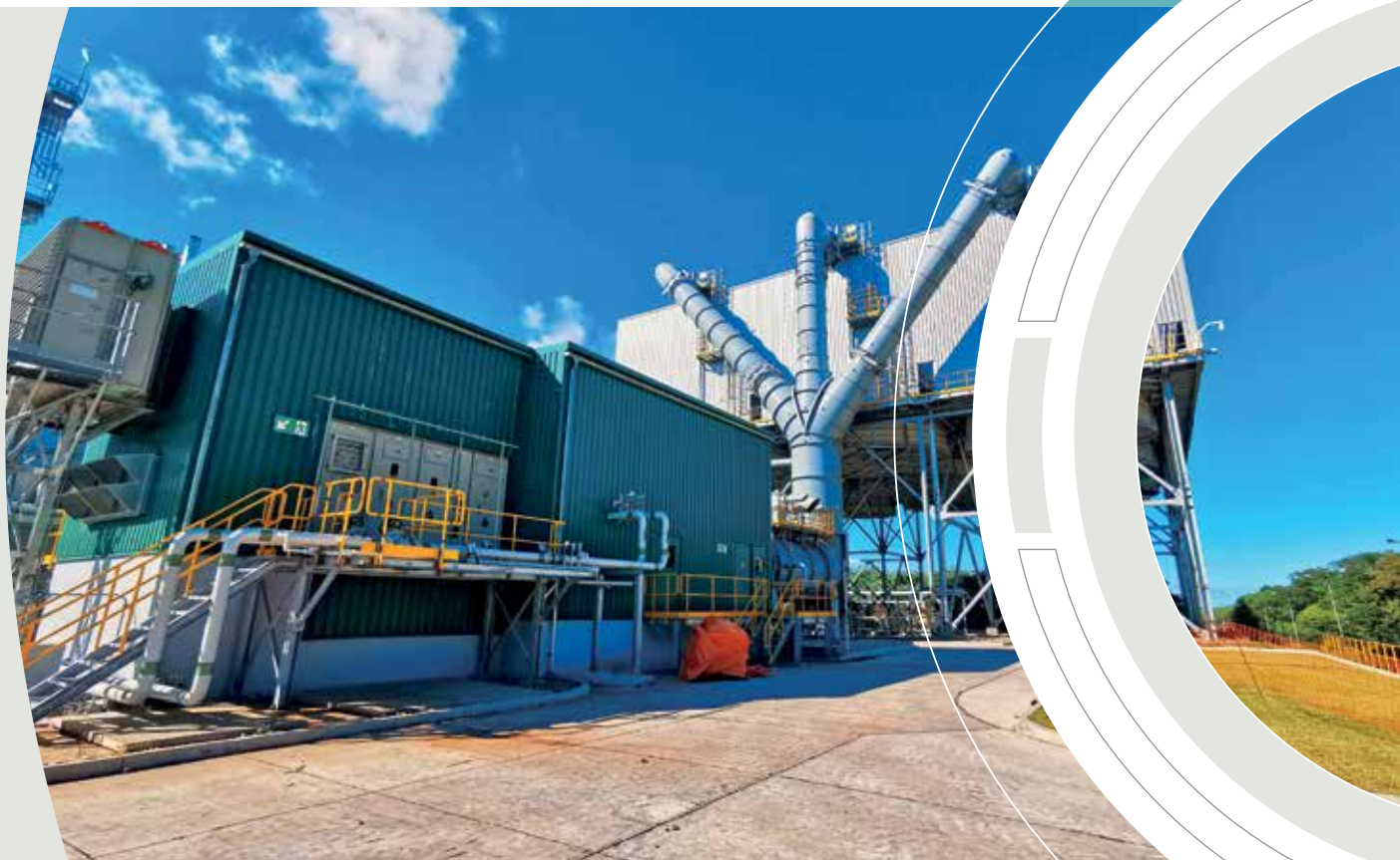
Planta Termoeléctrica del Sur - ENDE ANDINA
