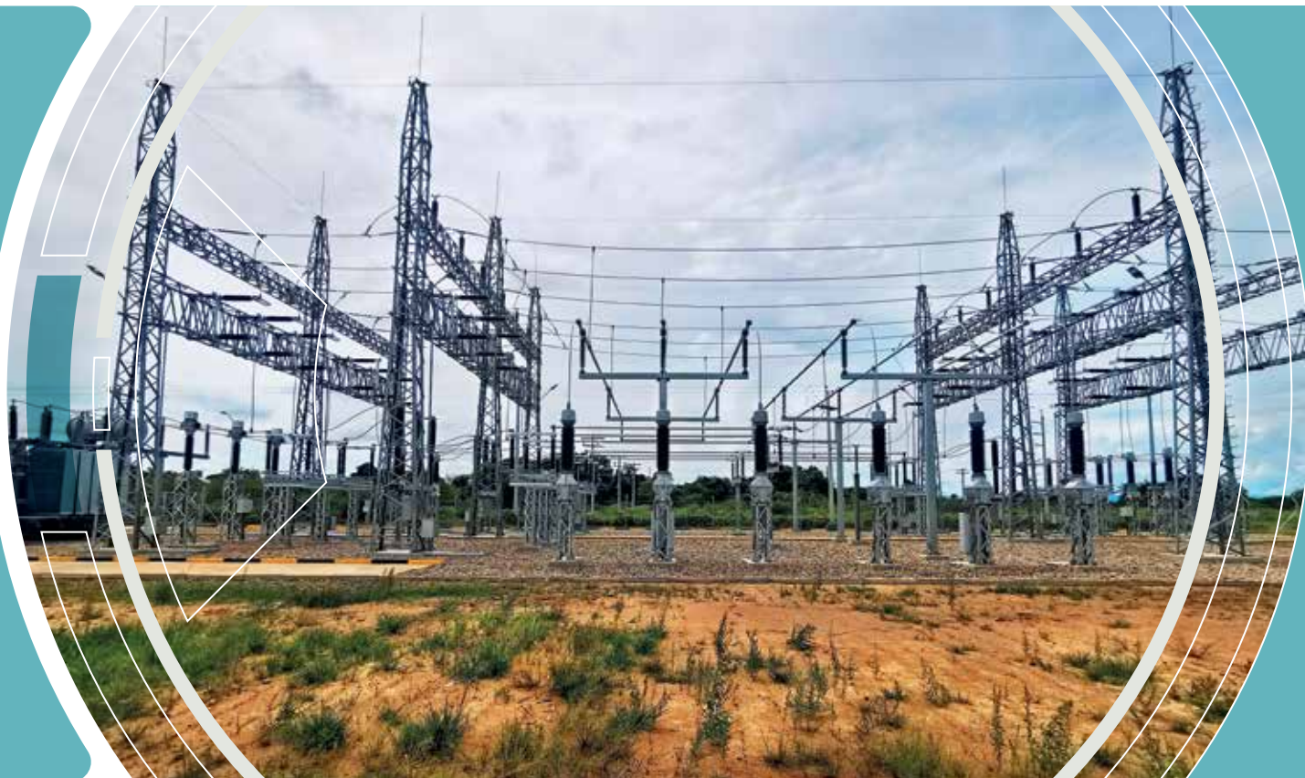
Subestación Valle Sanchez - CRE
