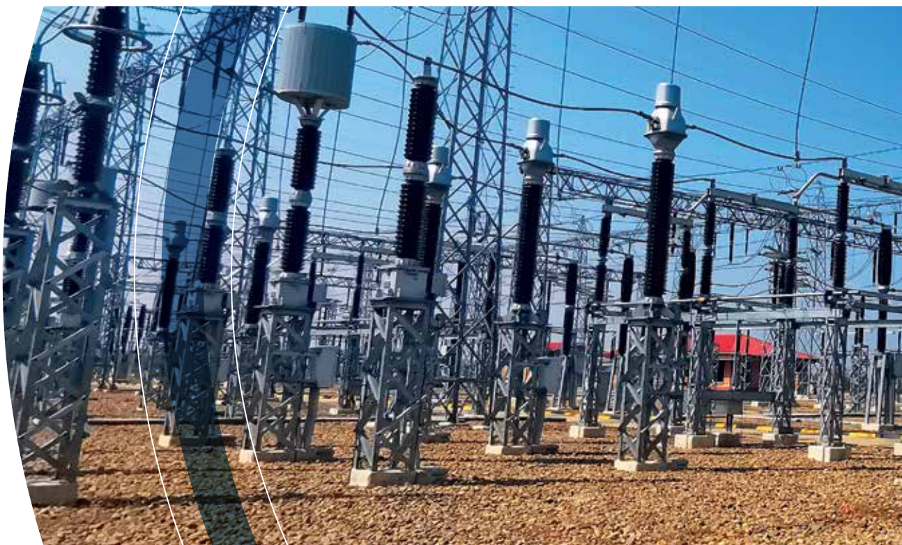
Subestación Bélgica 230/115 kV - ENDE TRANSMISIÓN
