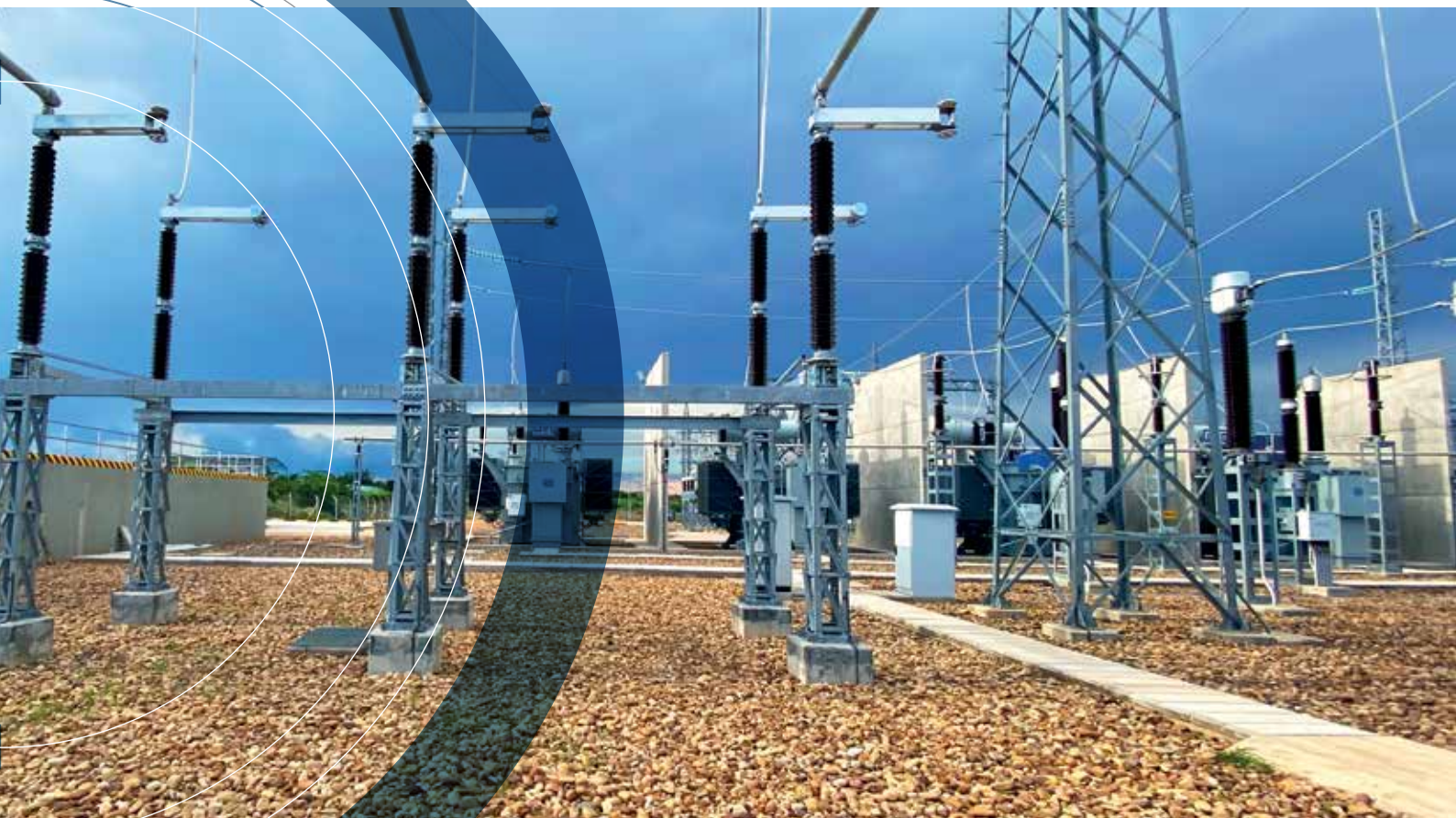
Línea Brechas - El Dorado 230 kV - ENDE TRANSMISIÓN
