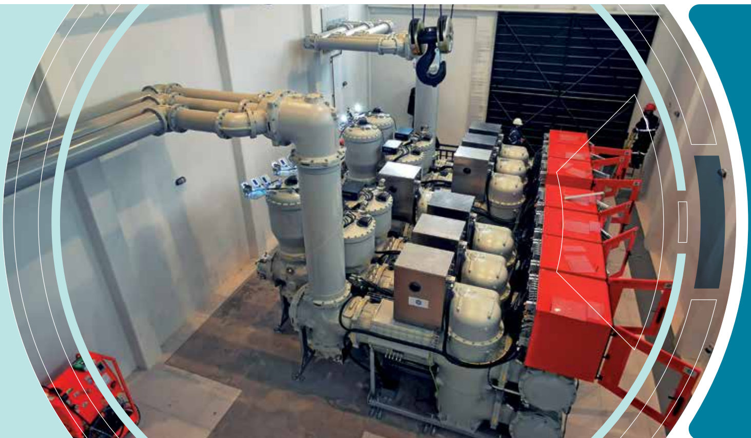
Subestación Alto La Paz 115 kV - DELAPAZ
