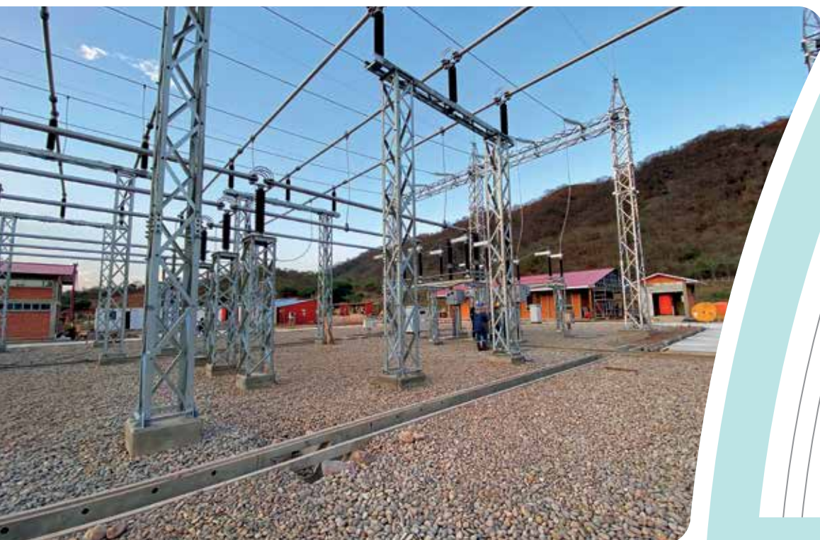
Interconexión Camiri al SIN - Subestación Camiri 115 kV - ENDE
