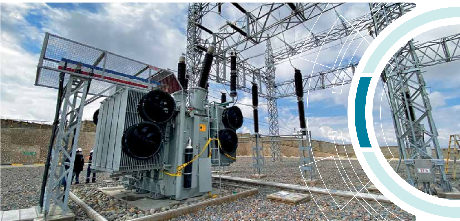
Subestación San Marcos 115/10,5 kV - SEPSA
