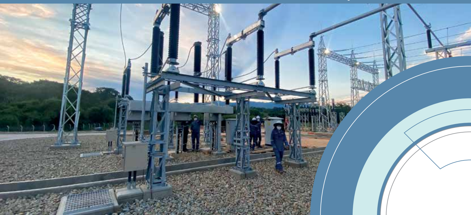
Interconexión Camiri al SIN - Subestación Monteagudo 115 kV - ENDE
