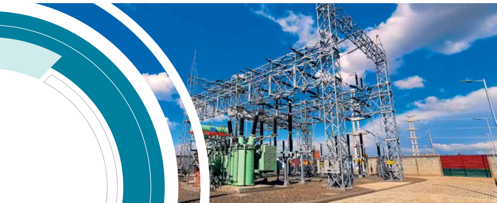
Subestación Viliroco 115 kV - DELAPAZ
