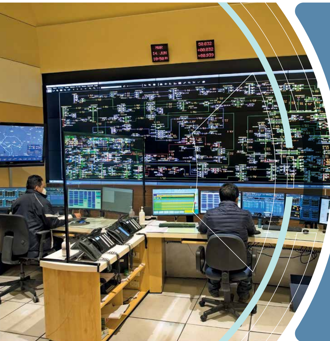
Sala de Control del CNDC
