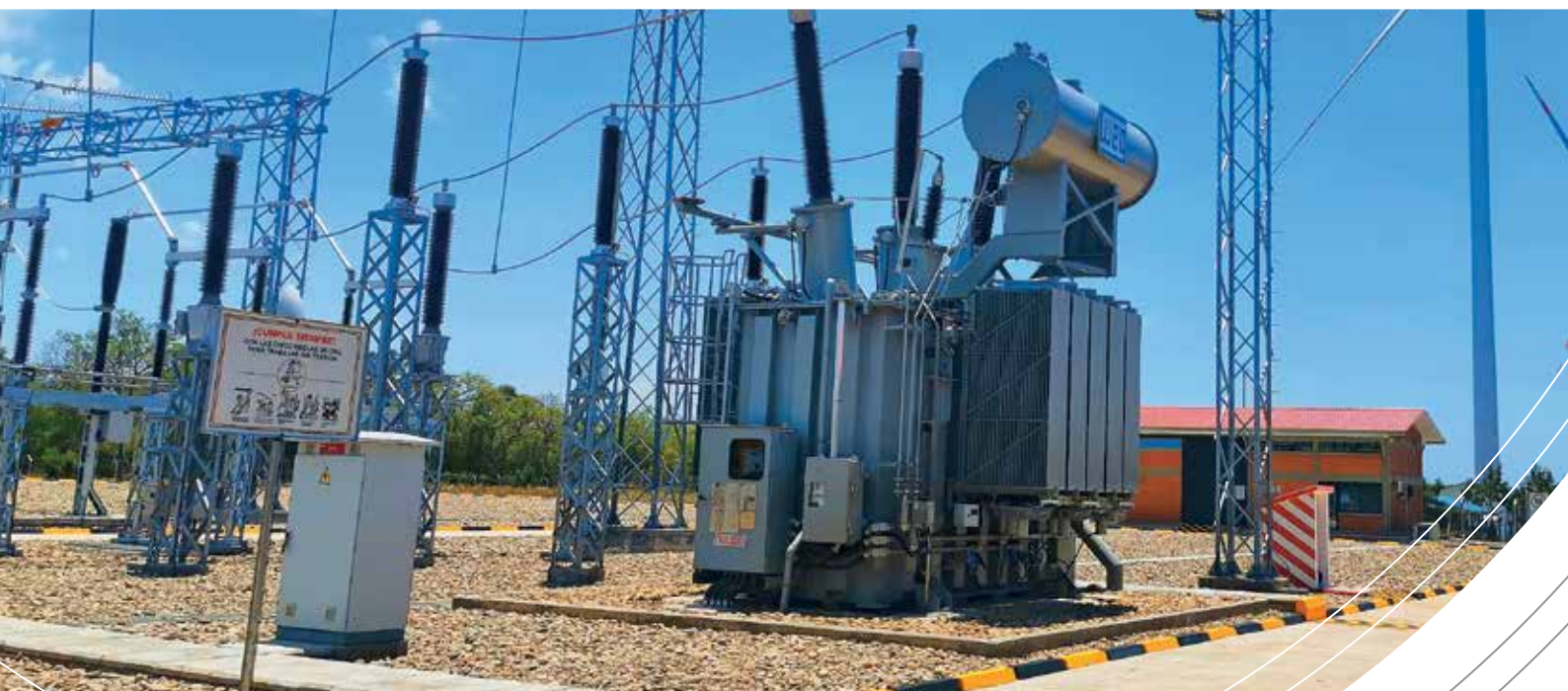
Transformador 230/24,9 kV - Subestación El Dorado - ENDE
