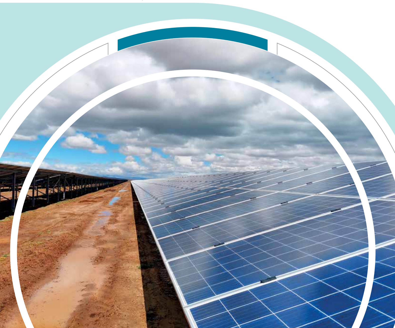
Planta Solar Fotovoltaica Oruro Fase I y II - ENDE
